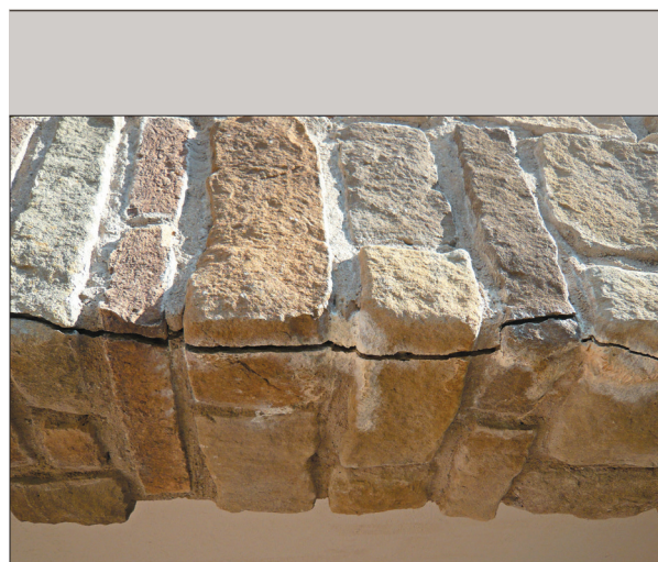
Nella fotografia si nota la rottura determinata dalla sola umidità che penetrando ha fatto dilatare i materiali, che muovendosi, hanno spaccato la pietra in corrispondenza degli angoli.
